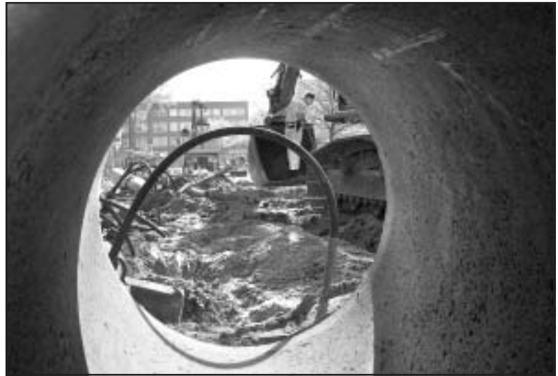
Graafwerkzaamheden zijn voor bijna 30 procent verantwoordelijk voor stroomstoringen op het laagspanningsnet.
